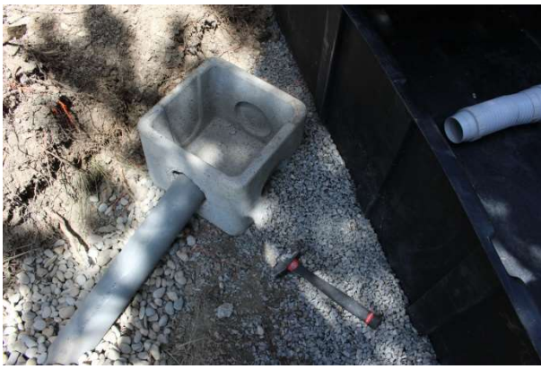
Podłączenie zbiornika na mocz do odpływu
